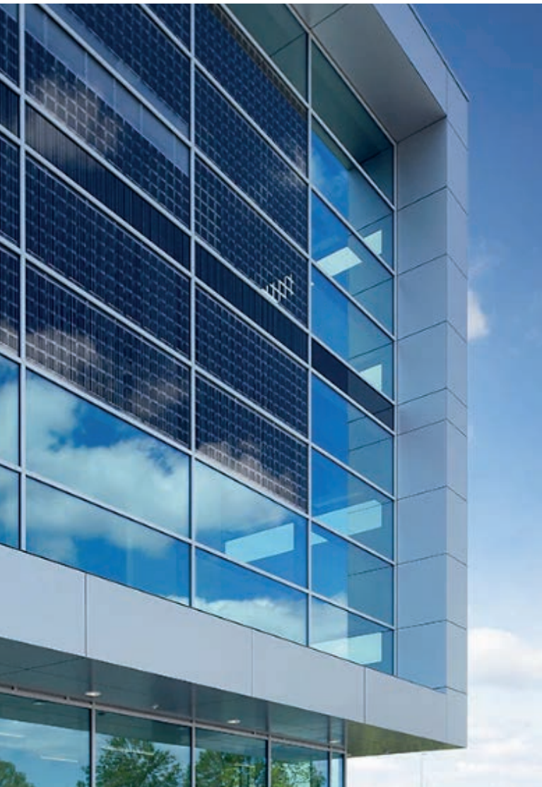
Die Photovoltaikanlage des Brand Experience Center ist ca. 450 m 2 groß und liefert rund 42.000 Kilowattstunden Strom pro Jahr. (Quelle: AUDI AG)
